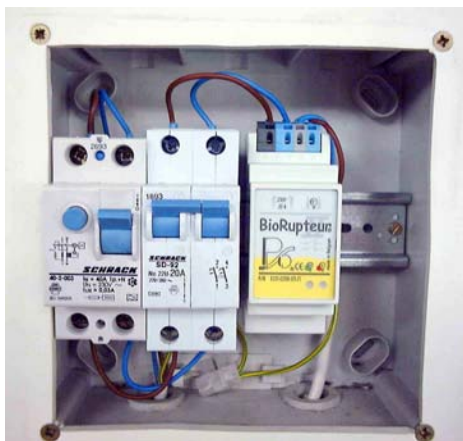
Fig.7 : Le BiorupteurII® dans le coffret de disjoncteurs
